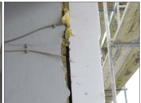
Mangel 3: Verkleben einer Fassade mit PUR-Schaum, die elektrischen Leitungen liegen ungeschützt hinter der Polystyrol-Dämmung.
