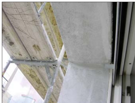
Mangel 2: Über den Fenstern, Balkontüren u. ä. müssen Stürze (A1) in die Dämmung eingesetzt werden. Dies wird oft unterlassen.
