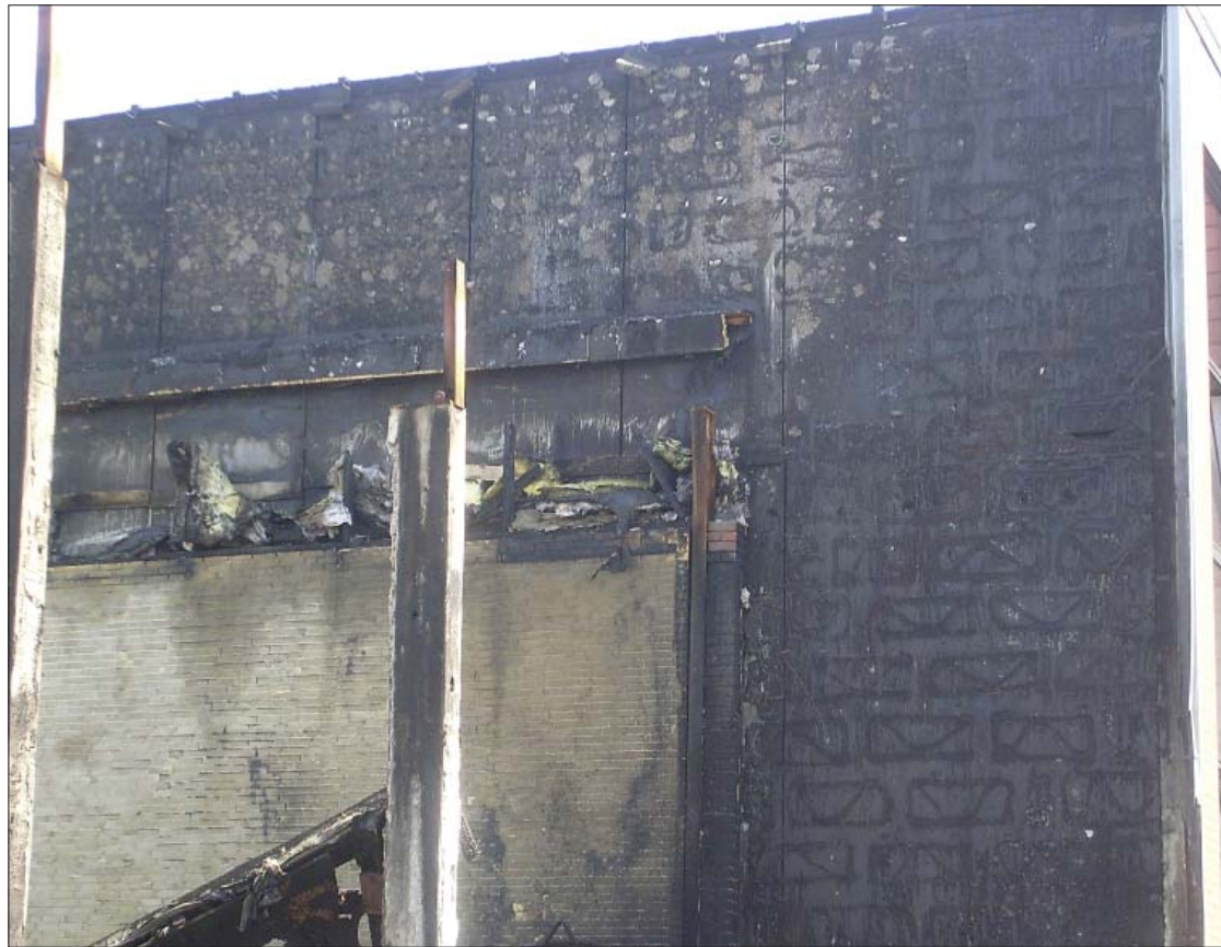
Rasant: In nur 35 s stand diese Fasadendämmung in Vollbrand und der Flammenüberschlag auf das Dach erfolgte. Trotz Riegelstellung konnte die Feuerwehr den Flammenüberschlag verbunden mit der Brandausbreitung über das Dach in das Gebäude nicht verhindern. Deutlich erkennbar die „Klebe“-Wülste – trotz richtiger „Verklebung“ kam es zu dem rasanten Abbrand.
